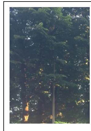
Armature ostruite dalle piante
