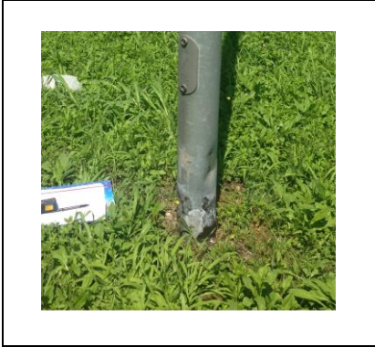
Protezione all'incastro mancante
